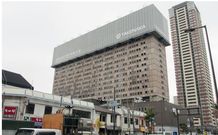
Systematisierter Gebäuderückbau in strukturierter Umgebung mittels teilautomatisierter Feldfabrik durch die Firma Takenaka.
