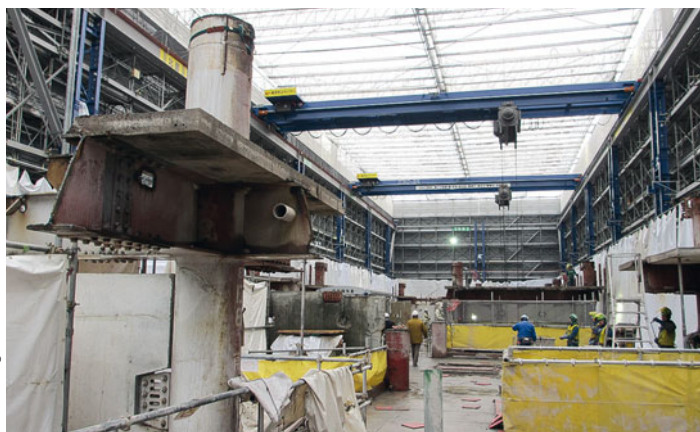
Innenansicht der teilautomatisierten Feldfabrik.
