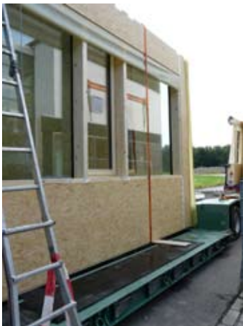
181. TES elements on a trailer.
