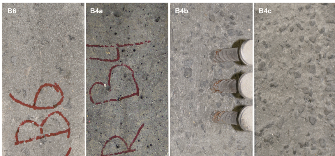
Bild 7.13: Fugenoberflächen der Stege der Plattenbalken B6, B4a, B4b und B4c nach dem Strahlen
