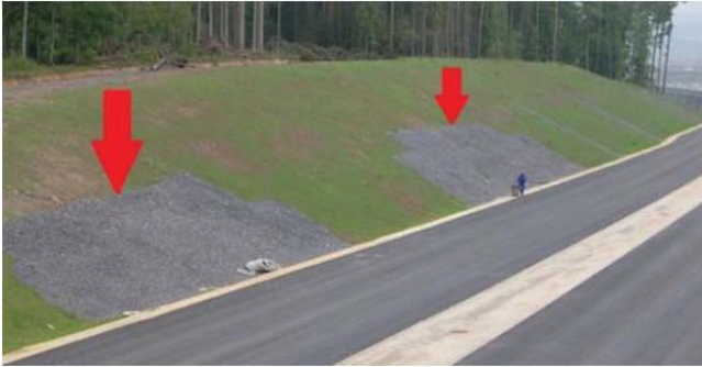
Abb. 4: Beispiel einer bereits im Bauzustand sanierten Böschung Fig. 4: Example of a slope, that has already been rehabilitated in the construction phase
