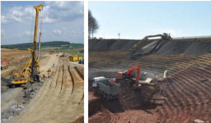
Abb. 9: Bauzustand Voreinschnitte Nord Tunnel Eierberge (links) und Tunnel Lichtenholz (rechts) (Fotos: ARCADIS/DB AG)
