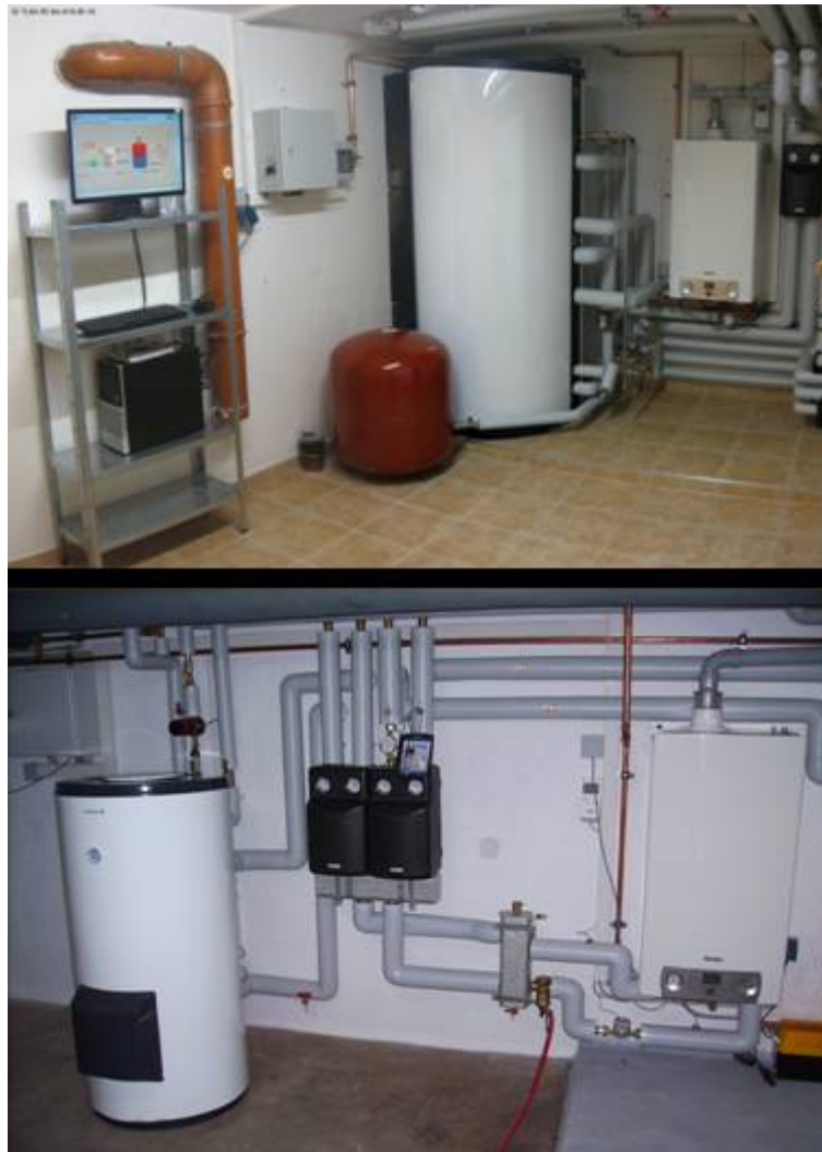
Abbildung 4: Kombispeicher und Warmwasserspeicher
