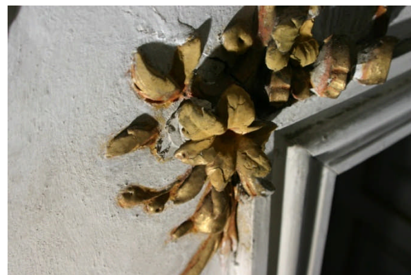
Abb. 281 Detail rechte Wand oberhalb der Eingangstür– Retusche mit ockerfarbenen Anstrich
