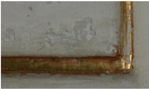
Abb. 184 Unter der Sichtfassung liegendes Weiß an der rechten Tür unten
