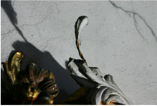
Abb. 263 Detail rechte Wand oberhalb des ersten Fensters - Drahtstabilisierung
