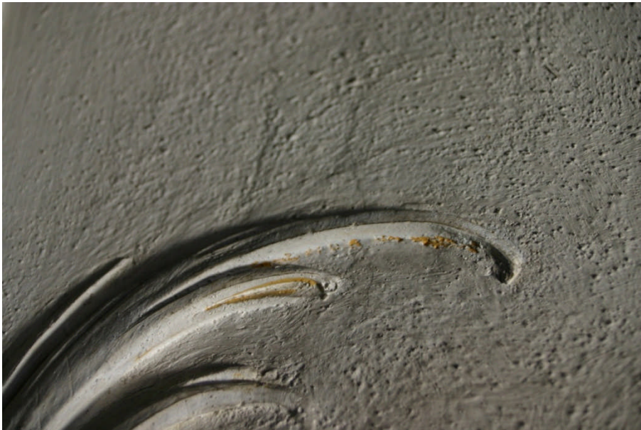
Abb. 144 Detail Stuck an der rechten Wand oberhalb der Empore
