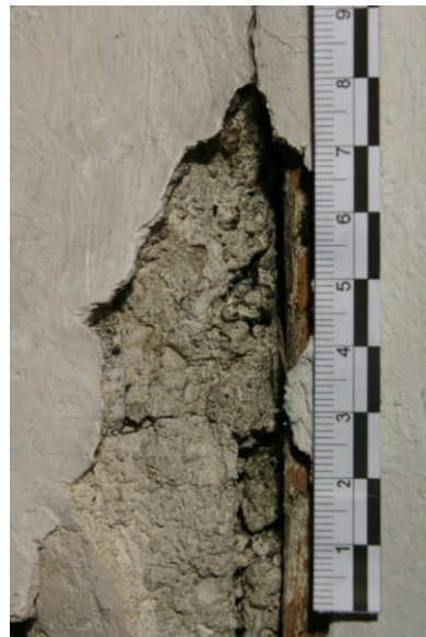
Abb. 252 Putzausbruchsstelle, erstes Obergeschoss; rechte Wand am Übergang zwischen Empore und Wandfläche
