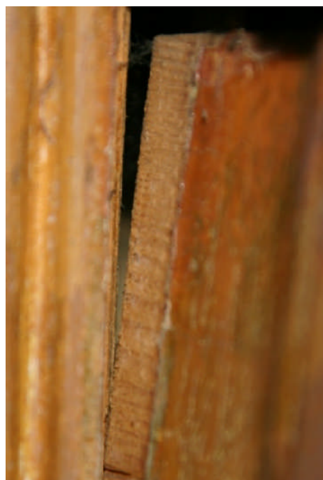
Abb. 195 geöffnete Fuge an Füllung III
