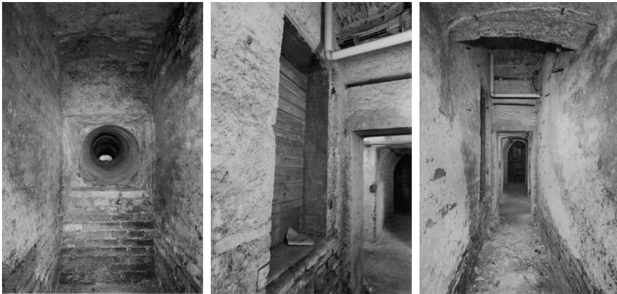
Abbildung 20: Versuchsobjekt Keller, links Außenwand mit einmündendem Kanal, Mitte Wandnische, rechts Schmalseite mit Zugang.
