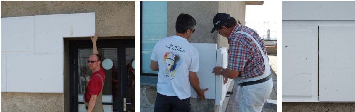
Abbildung 111: Passgenaue Elemente am Türeck (links), Berücksichtigung des Ecküberstandes (Mitte), offene Fuge aufgrund eines Planfehlers (rechts)
