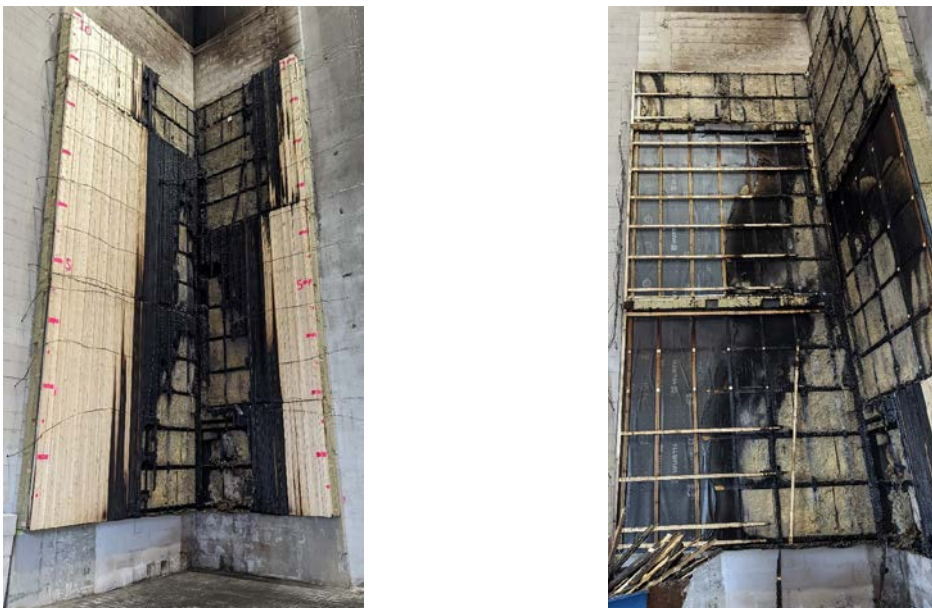
Abbildung 3.7 Fassade (link) direkt nach Brandversuch, (rechts) nach Rückbau der Holzschalung
