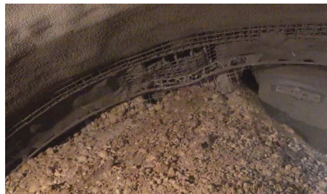
Abb. 4-22: Ausweitung des lokalen Versagens bis hin zum Verbruch
