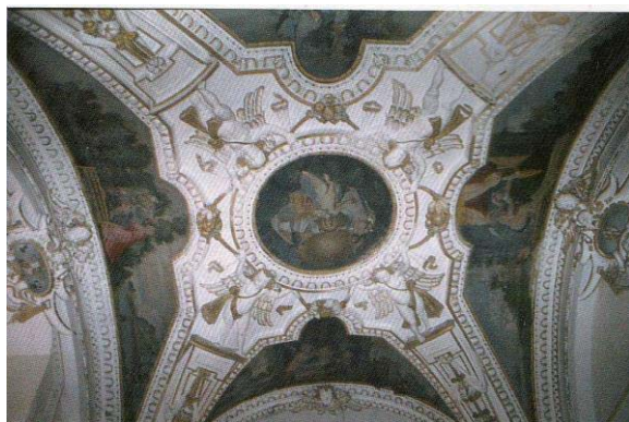
Abb. 160: Stuckdecke der Schlosskapelle in Dürnk- rut, NÖ, von 1633. Sog. Marouflagebilder der Stuck- decke vor der Restaurierung [KOLLER/VIGL 2005, S. 180].
