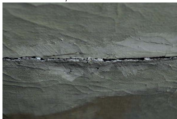
Abb. 118: Putzbrösel in Riss der Kittung zwischen den Leinwandstößen. Die Leinwand ist hier an den Rändern etwas ausgeleiert und hängt durch, weshalb sich die Putzbrösel hier gut sammeln können.
