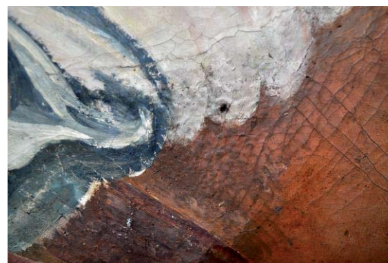
Abb. 173: Schaden durch Wassereintritt durch die Decke. Der Putz scheint feucht geworden und bildet kleine Hügel unter der Leinwand (brauner Bereich). Zusätzlich zeigt sich in dem weiß-blauen Gewand eine Ergänzung.
