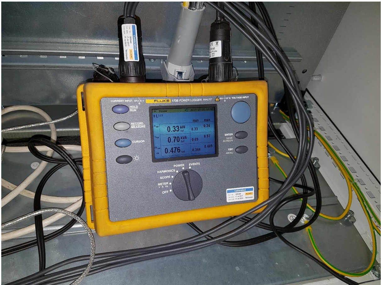
Abbildung 6-3: Fluke 1735 Messgerät im stationären Schaltschrank
