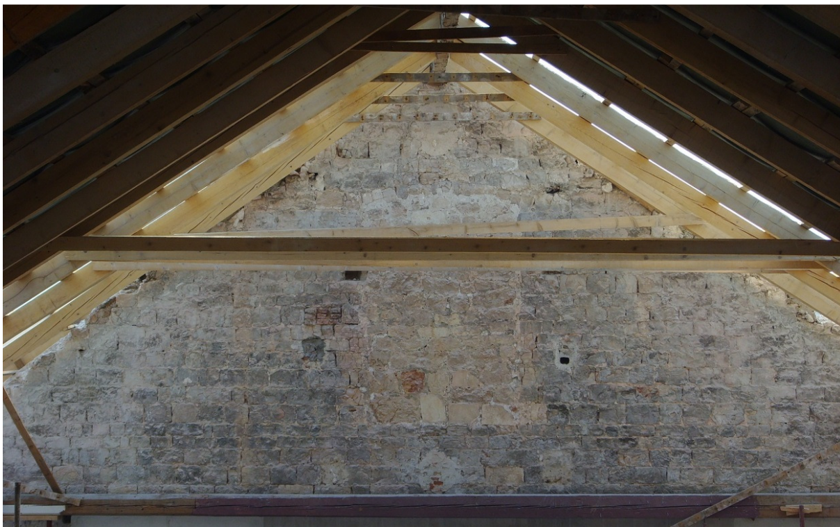
Bild 173 Die östliche Fassade: der Giebel im Inneren – Brandschaden 458
