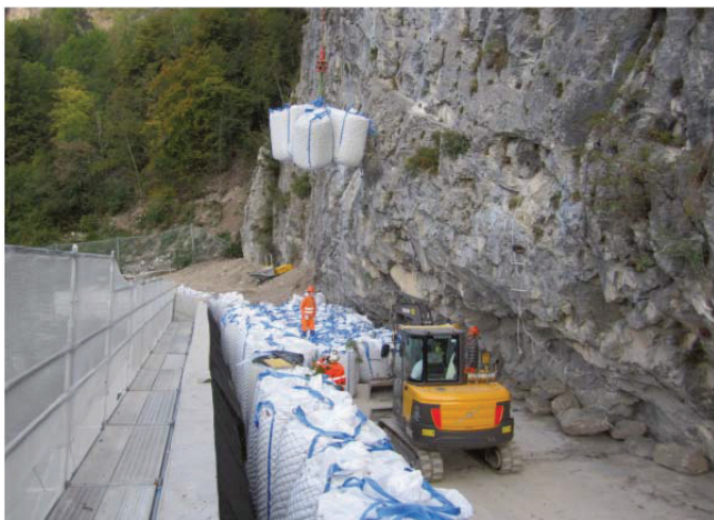
Abb. 13: Die einzelnen Dämpfungsmodule wurden mit dem Helikopter auf das Galeriedach geflogen und aneinandergereiht. Fig. 13: The damping modules were flown by helicopter to the roof of the rockfall protection gallery and positioned.
