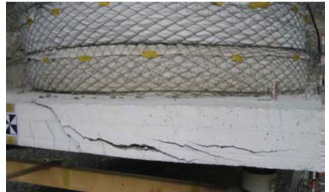
Abb. 5: Schubversagen der Versuchsbetonplatte nach mehreren Aufschlagsversuchen.
