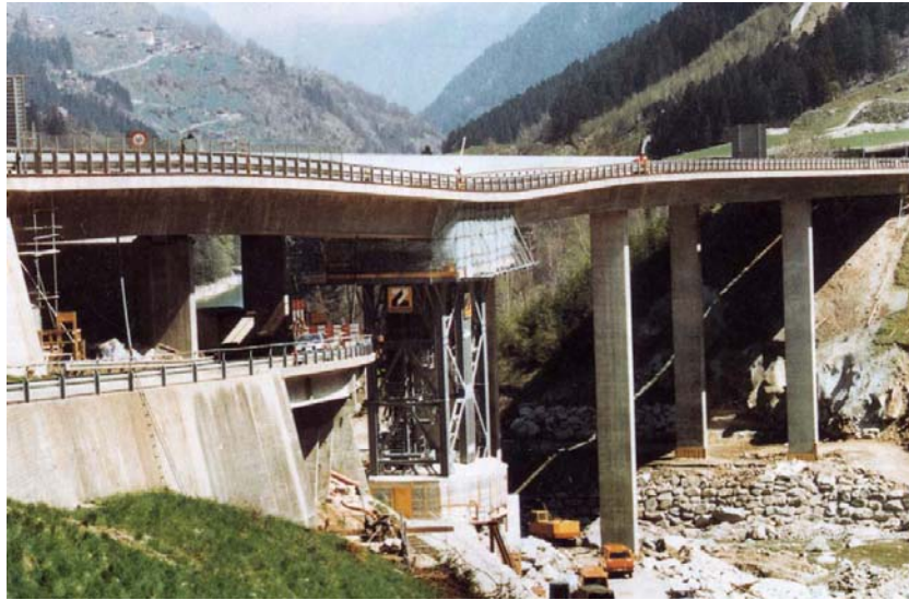
Bild 5.1: Reussbrücke Wassen (Schweiz) nach einem Hochwasserereignis am 15.08.1987 [de Witte u. a. 1989]
