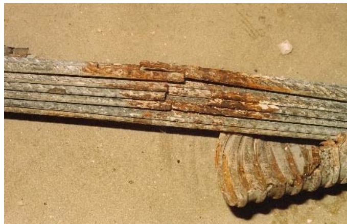
Bild 6.1: Beispiel für Korrosion der Spanndrähte eines Spanngliedes im Bereich eines lokalen Verpressfehlers, aus [Nürnberger u. a 1994]
