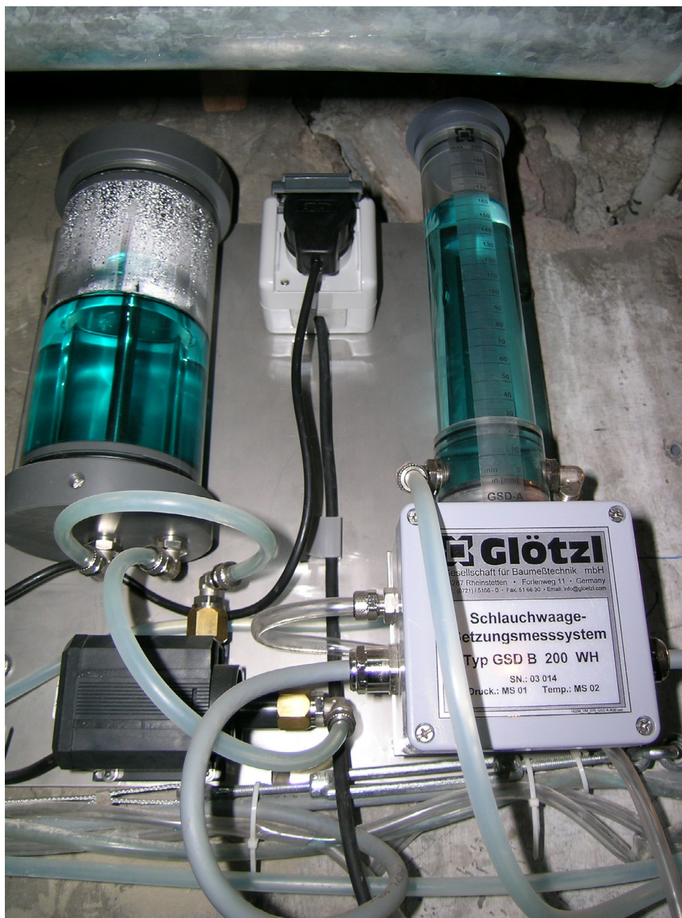
Bild 6: Referenzstation mit Erweiterung zum Umwälzbetrieb
