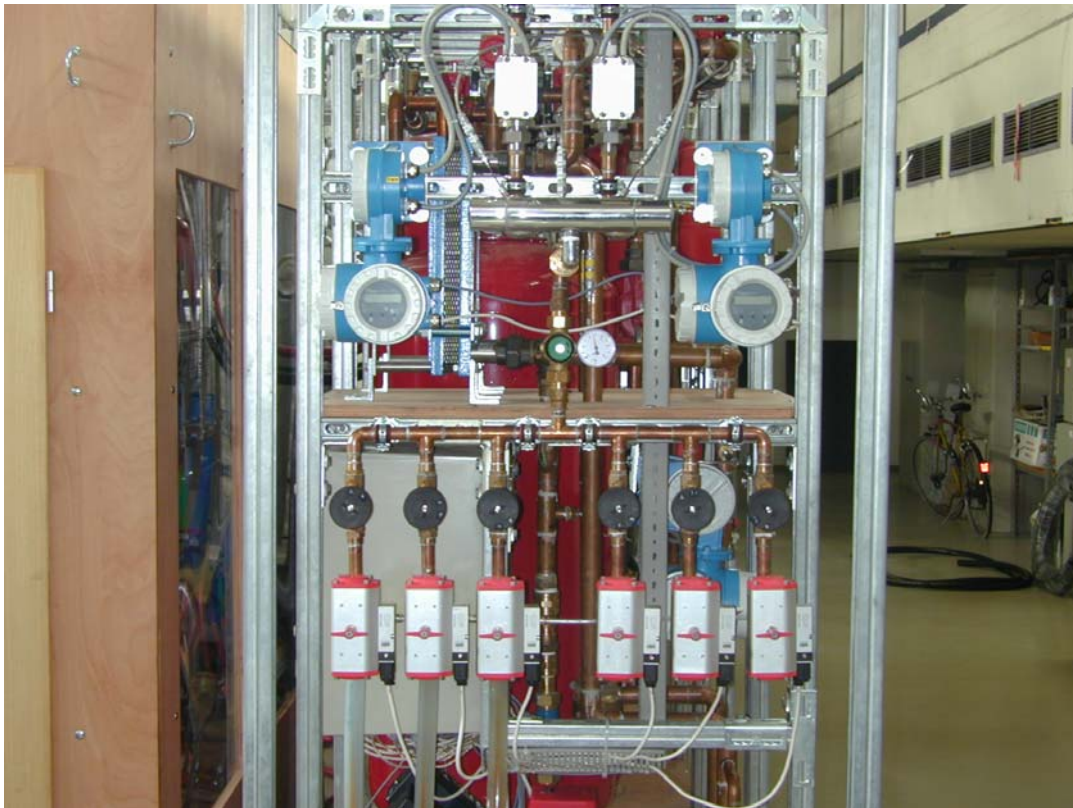
Abbildung 11-5: Warmwasserzapfstellen am Wärmeerzeugerprüfstand
