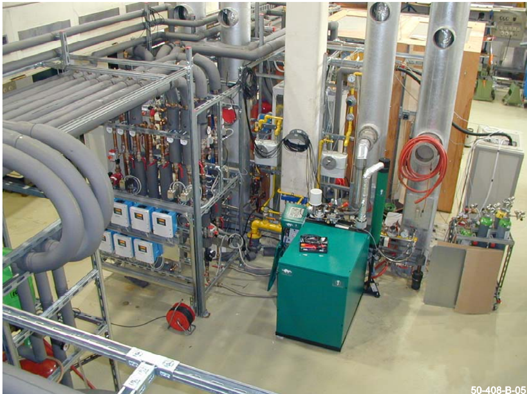
Abbildung 8-3: Prüfling und Hydraulik-Rack
