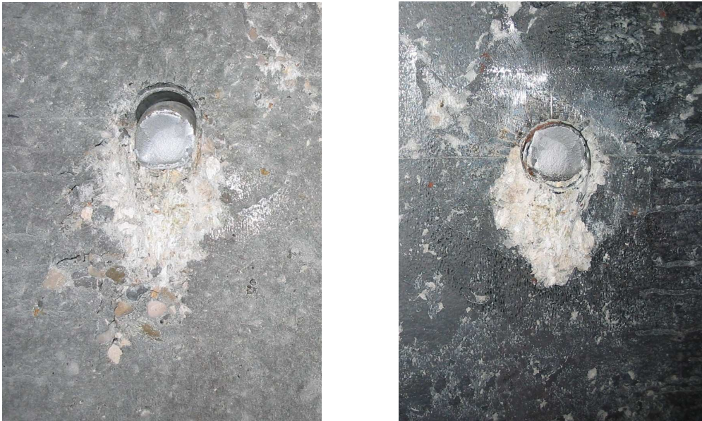
Abbildung 3.44: Gurt KI5.8.2 – Betonausbruch vor dem Dübel 3 links: Ansicht Betongurt rechts: Ansicht Stahlgurt
