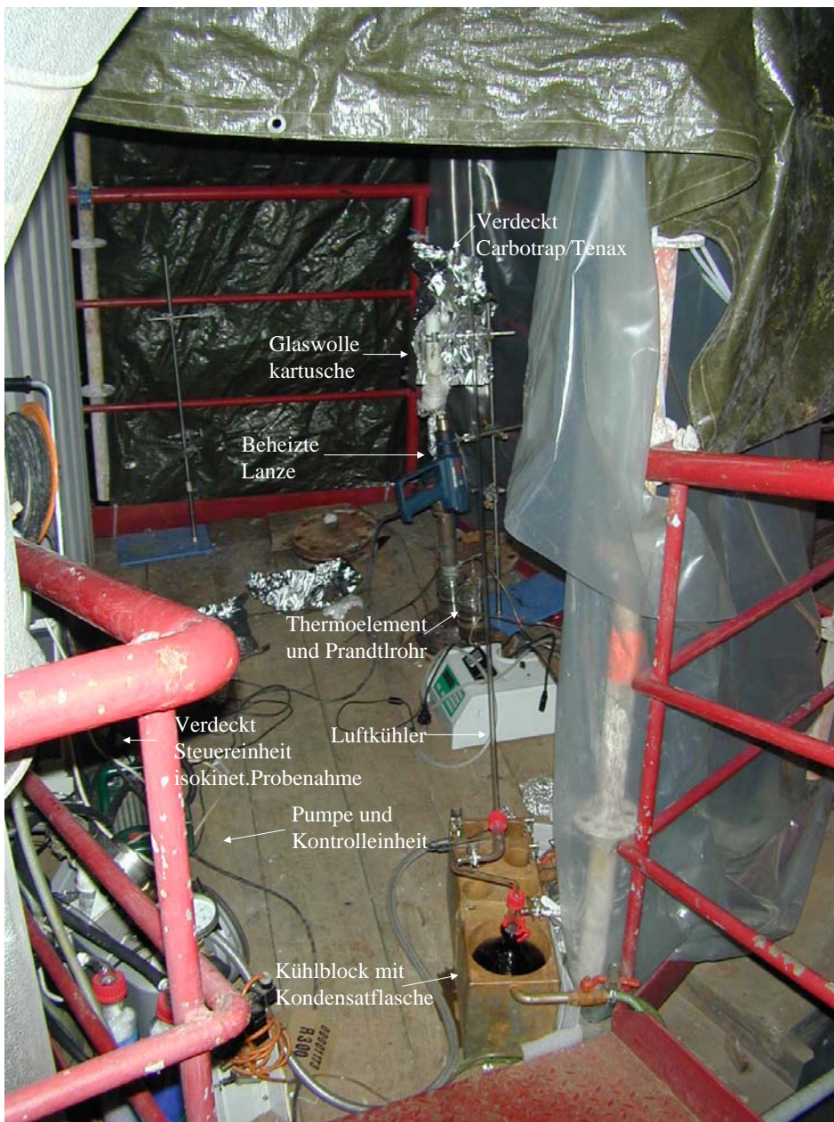
Abbildung 3-8: Foto des Probenahmeaufbaus an der Hausmüllverbrennungsanlage 1
