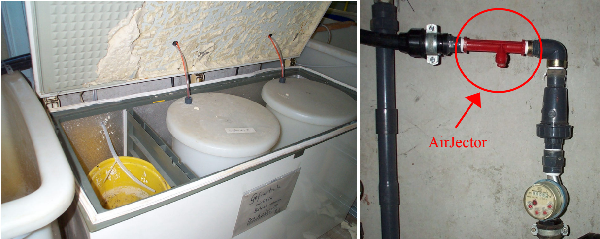
Abb. 7: Links: Vorratsbehälter für H 2 O 2 (Variante H1 und H2) in einer außer Betrieb genommenen Gefriertruhe zur Temperaturstabilisierung des Peroxids. Rechts: AirJector Fa. Mazzei (Variante A), USA
