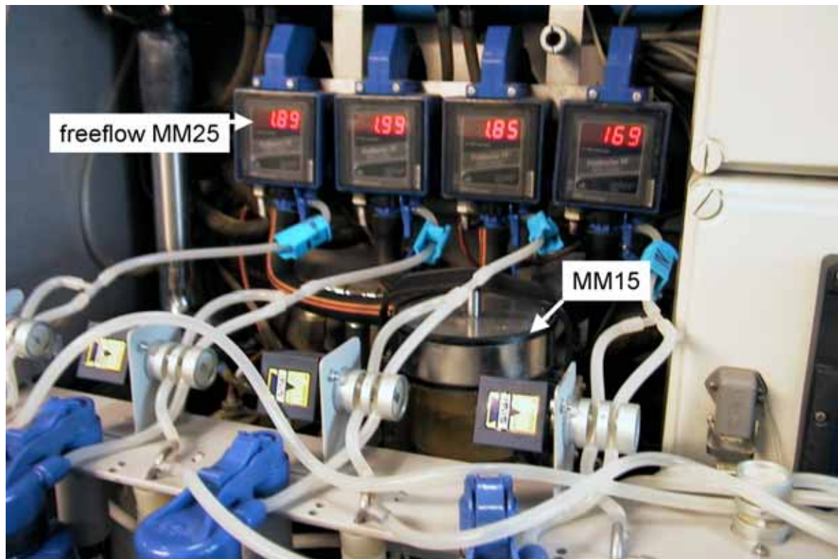
Abbildung 7: Detailansicht (1) der viertelspezifischen Probenahmeverrichtung: Anschluss der Probenehmer an den freeflows MM25
