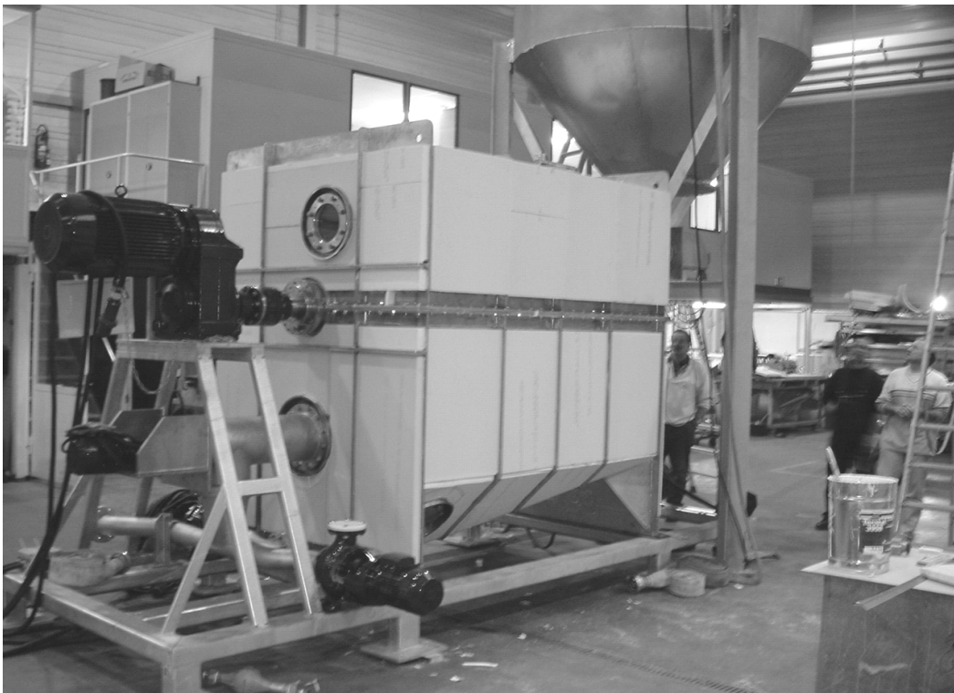
Bild 6.4-3: Aufwändige Isolierung des Wäschers zur Reduktion der nötigen Heizenergie während der Nutzungsphase
