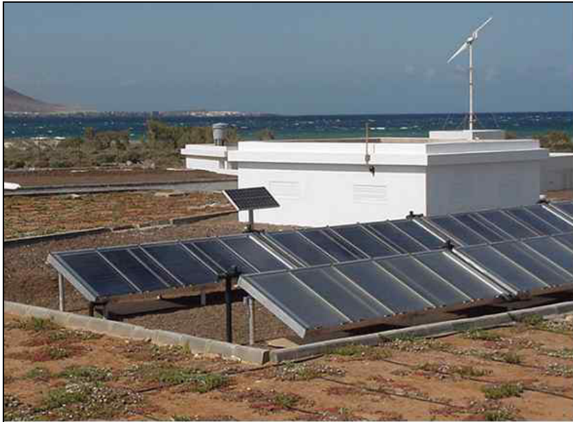
Abbildung 40: Außenansicht der Meerwasserentsalzungsanlage Pozo Izquierdo (Gran Canaria) auf dem Gelände des Kanarischen Energie- und Wasserforschungsinstitutes CIEA.
