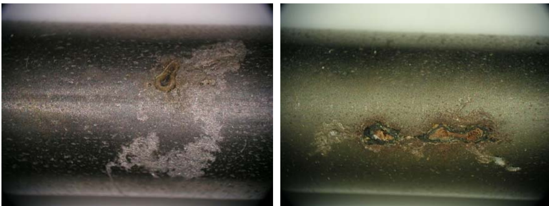
Bild A14: Aufnahmen von geätzten Korrosionsstellen, links: Probe a, rechts: Probe b; Versuchsparameter s. Bild A13
