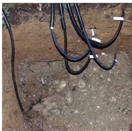
9 In einem Datenloggerkasten (oben) werden die Messwerte der Bodentemperatur und -feuchtigkeit gesammelt und abgespeichert. Die Sensoren werden in verschiedenen Bodentiefen eingebaut (unten). Nach dem Einbau wird das Bodenprofil wieder verfüllt. Foto: H.-J. Krause, LWF
