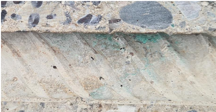
Abbildung 4-40: Zone des gestörten Verbundes am Beispiel Riss Ost Segment S 7 mit eingefärbten Epoxidharz
