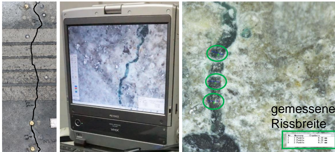
Abbildung 4-1: Rissverlauf (links), Erzeugung der Bilddatei mit 100-facher Vergrößerung mit digitalem Mikroskop (Mitte), digitale Messung der Rissbreite exemplarisch an drei Stellen (rechts)
