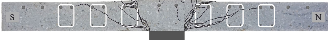
Bild A.128: Rissbilder der Trennschnitte 1 und 2 des Versuchskörpers M0-25-1.75-B10
