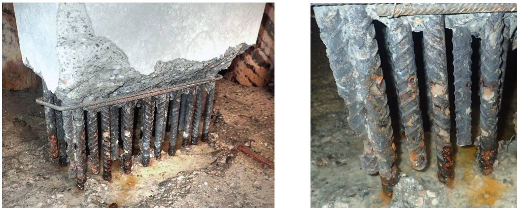
Abb. 4: Chloridinduzierte Korrosion an Stützenlängsbewehrung während Abtragsarbeiten des chloridbelasteten Betons mittels Höchstdruckwasserstrahlen im Zuge einer konventionellen Instandsetzung [eigene Fotos].
