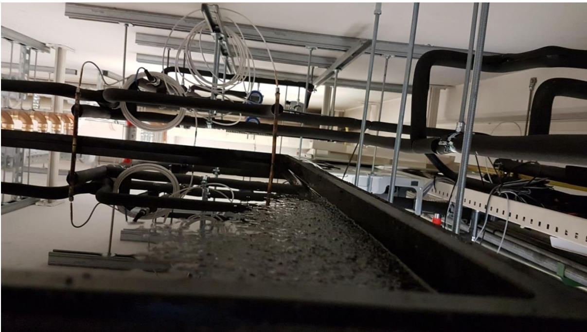
Abbildung 7-13: Versuchswärmeübertrager (Draufsicht auf den offenen Behälter) nach Installation, Befüllung und kältetechnischer Verrohrung.
