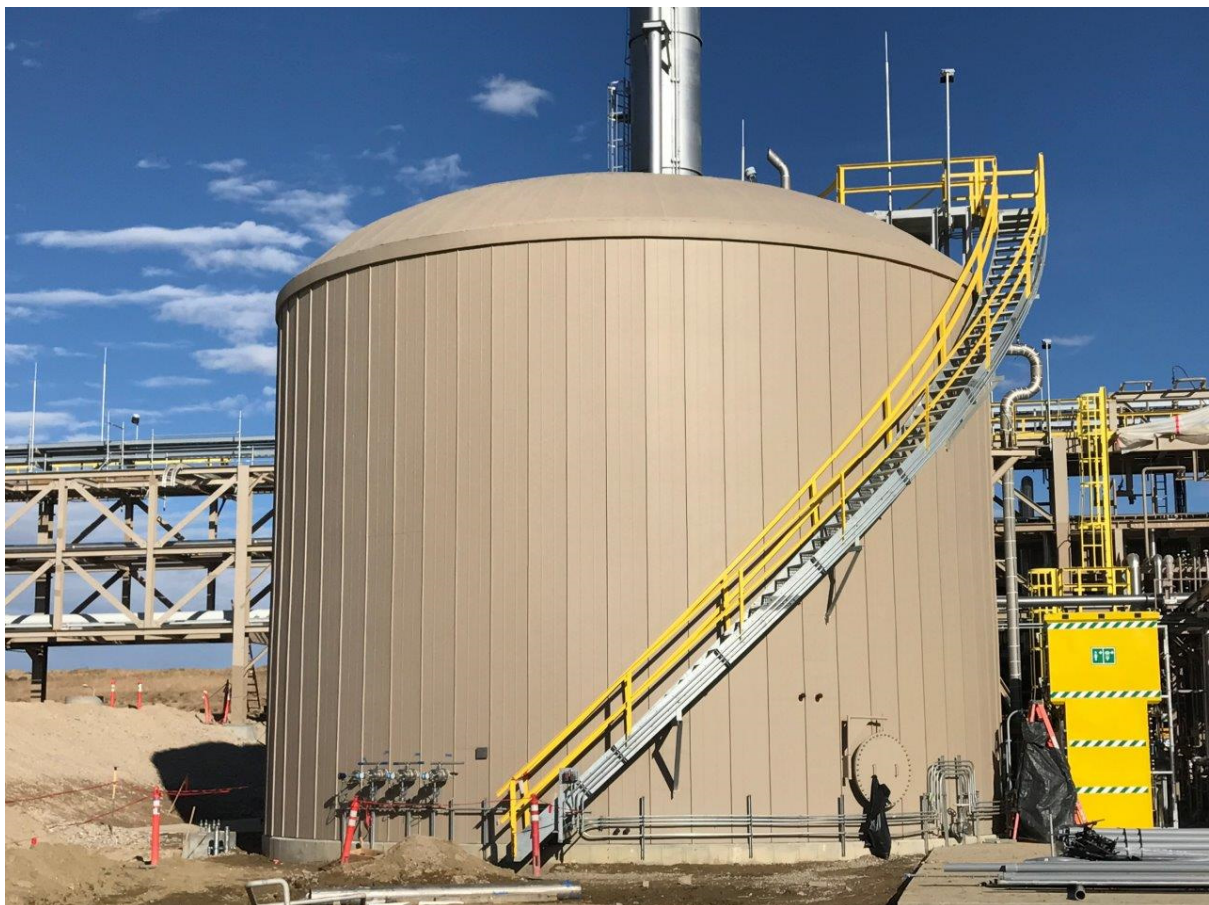
Abbildung 3-1: Flachbodentank zur Lagerung von Flüssigkeiten (Warmtank)
