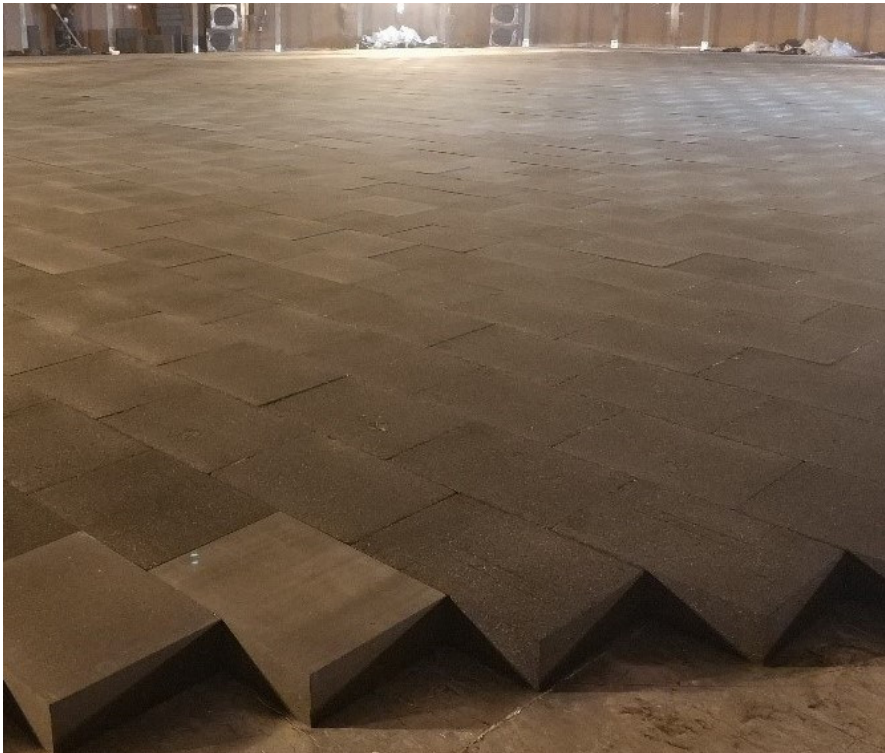
Abbildung 4-5: Bodendämmung eines Kalttanks
