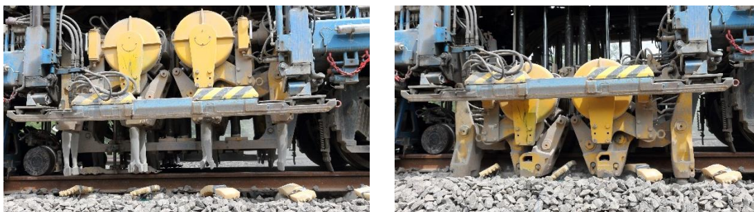
Abbildung 2: links - Stopfpickel über dem Gleis vor dem Eindringen; rechts - Stopfpickel sind eingetaucht und im Beistellvorgang
