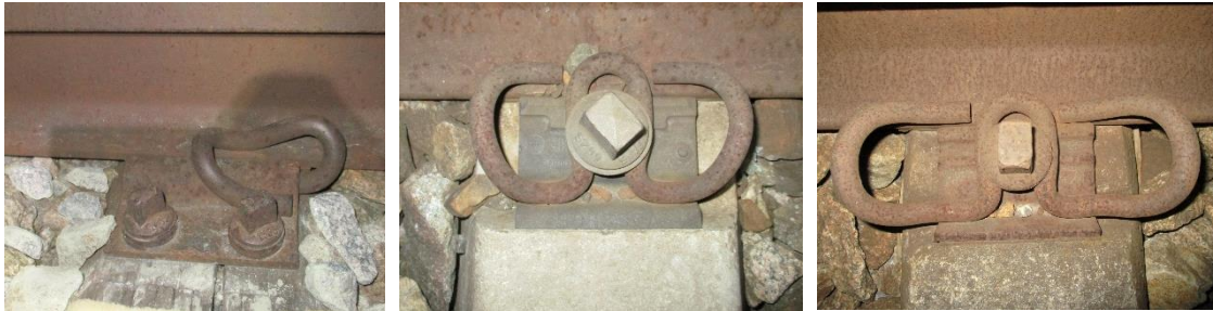
Abbildung 42: Oberbauformen: links - Holzschwelle mit Pandrol; mitte - Betonschwelle L2 mit Kst Wfp; rechts - Betonschwelle 19a mit Stahl-Wfp
