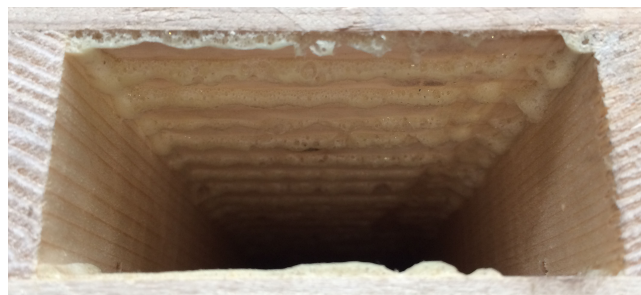
Abbildung 2.23: Spannkanal mit sichtbaren Klebstoffanhaftungen
