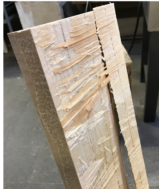
(b) mangelhafte Verklebung der Decklamelle
