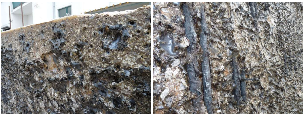
Abb. 7-24: Geschmolzene Zuschlagsstoffe und geschmolzene Bewehrung (P-RWS-70-0,9PP).
