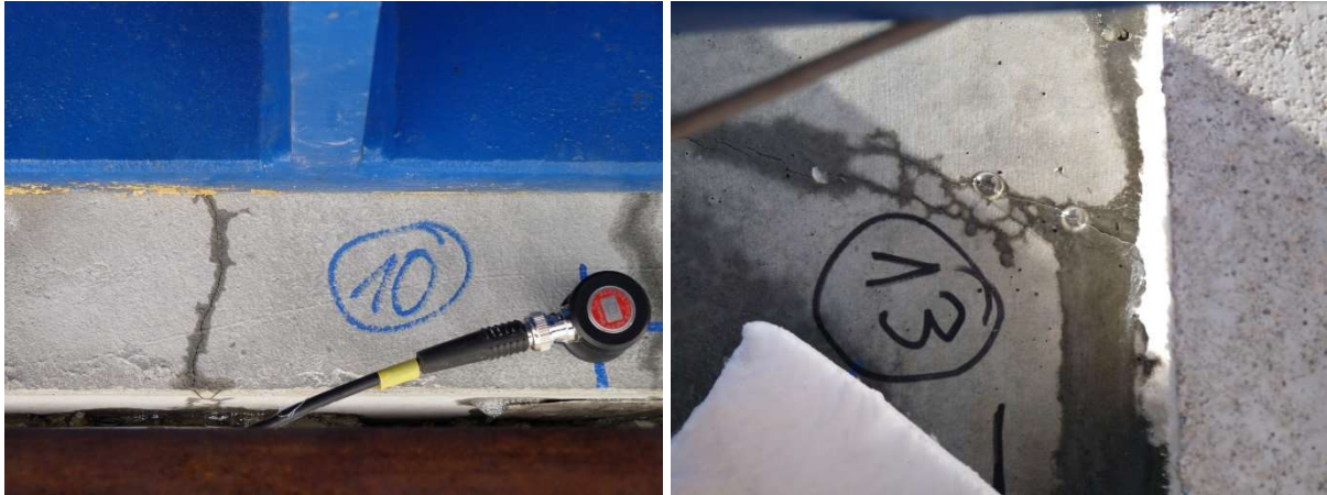
Abb. 7-16: Wasserführende Risse an der Testkörperoberfläche (P-RWS-70-0,9PP).
