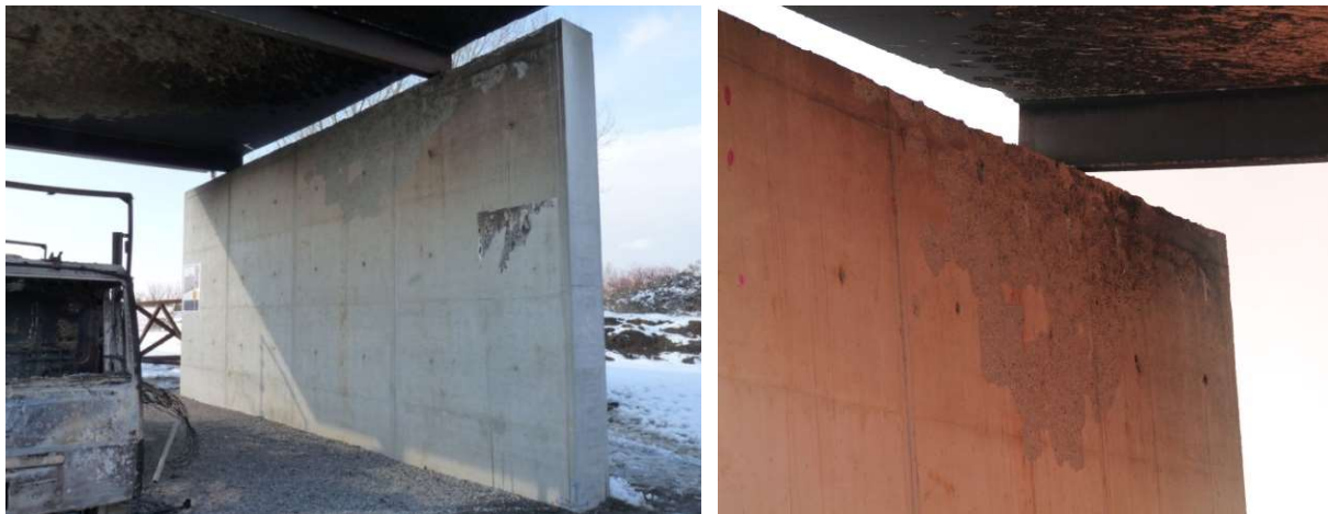
Abb. 5-15: Durch Abplatzungen geschädigter Bereich der Wand aus verschiedenen Blickwinkeln.
