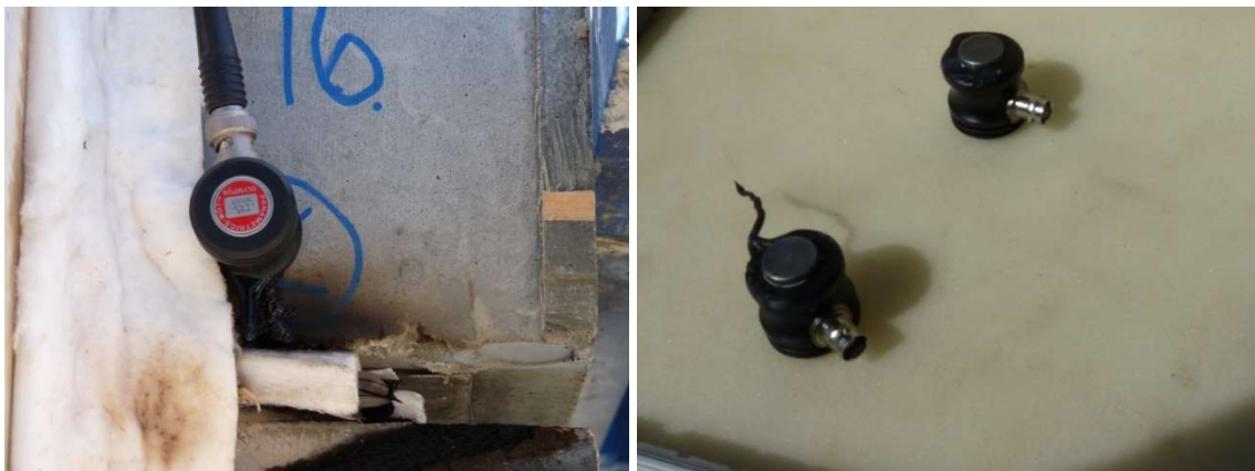
Abb. 6-7: Durch Temperatureinwirkung abgelöste und beschädigte Sensoren.
