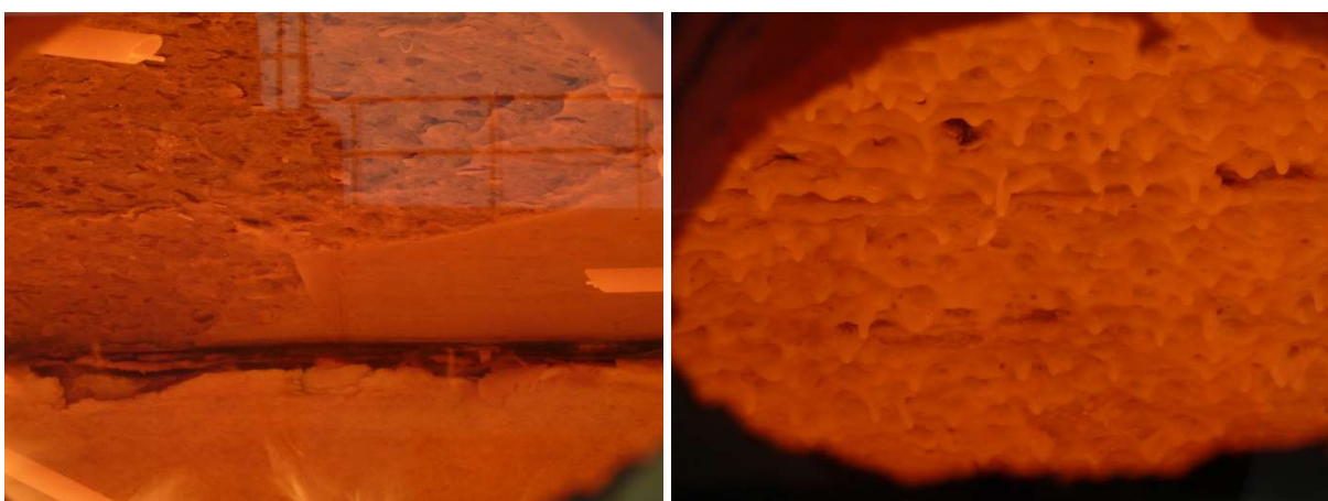
Abb. 7-14: Links: Beobachtung von Abplatzungen bei einer Brandbelastung bis 1200°C (P-ZTV-70-0,9PP) und einem Schmelzen der Zuschlagsstoffe und der Stahlbewehrung bei einer Brandbelastung bis 1350°C (P-RWS-70-0,9PP).
