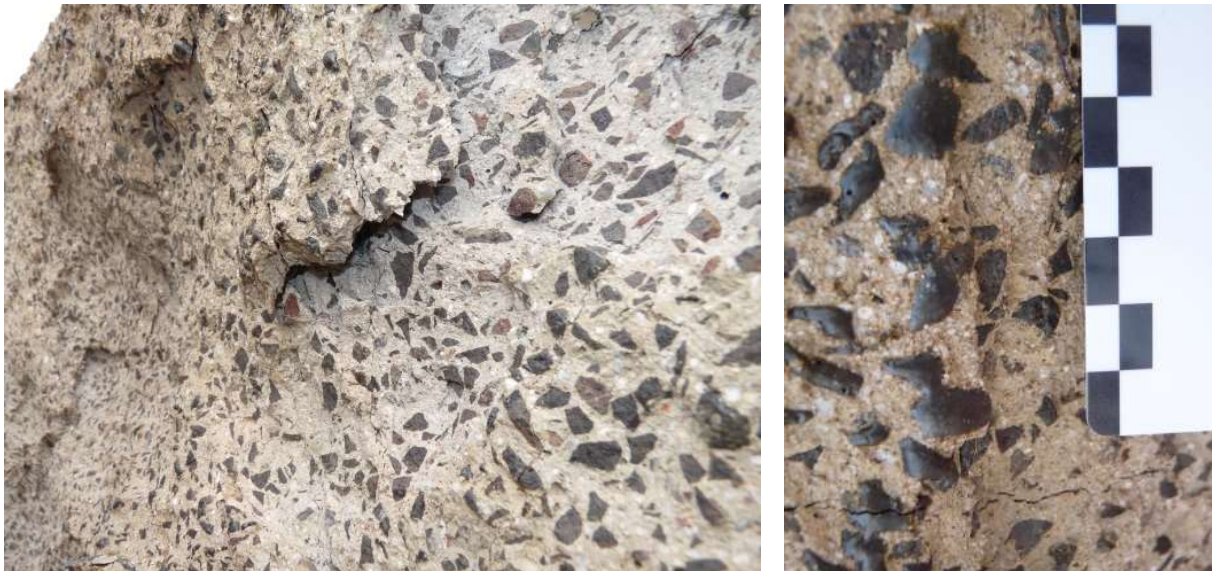
Abb. 7-21: Abgeplatzter Bereich mit Schalenbildung parallel zur Oberfläche (links) angeschmolzene Zuschlagsstoffe (rechts). Beides nach einer Brandbelastung nach ZTV-ING (Q-ZTV-90-0PP).
