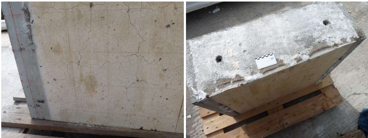
Abb. 7-23: Verfärbung der Betonoberfläche der beflamten Oberfläche und die fein verästelte Struktur kleiner Risse auf der Oberfläche.
