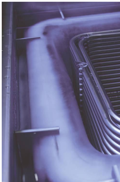
Abbildung 10: Eiswasseranlage Eisschicht an Kühlkreislauf [17]
