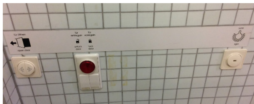
Bild 5 - Tür- und Lichtschalter
