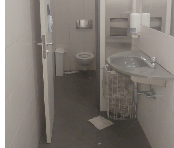
Toilette wirkt schmutzig und entspricht in nur einem Punkt der DIN Norm. Ansonsten wirkt der Raum wie eine Falle für Rollstuhlfahrer (keine Wendemöglichkeit).
