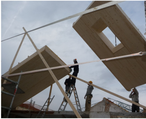
Abbildung 43: Auffrichte im leanWOOD-Fallbeispiel MFH Saumackerstrasse: Vorgefertigte Dachelemente werden auf das bestehende Gebäude versetzt.
