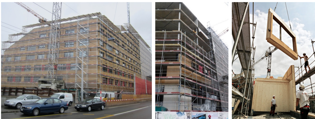
Abbildungsserie 3: Montage der Holzelemente in der Wohn- und Gewerbesiedlung Kalkbreite Zürich. Bilder: Müller Sigrist Architekten (links und Mitte), Pavatex SA (rechts).
