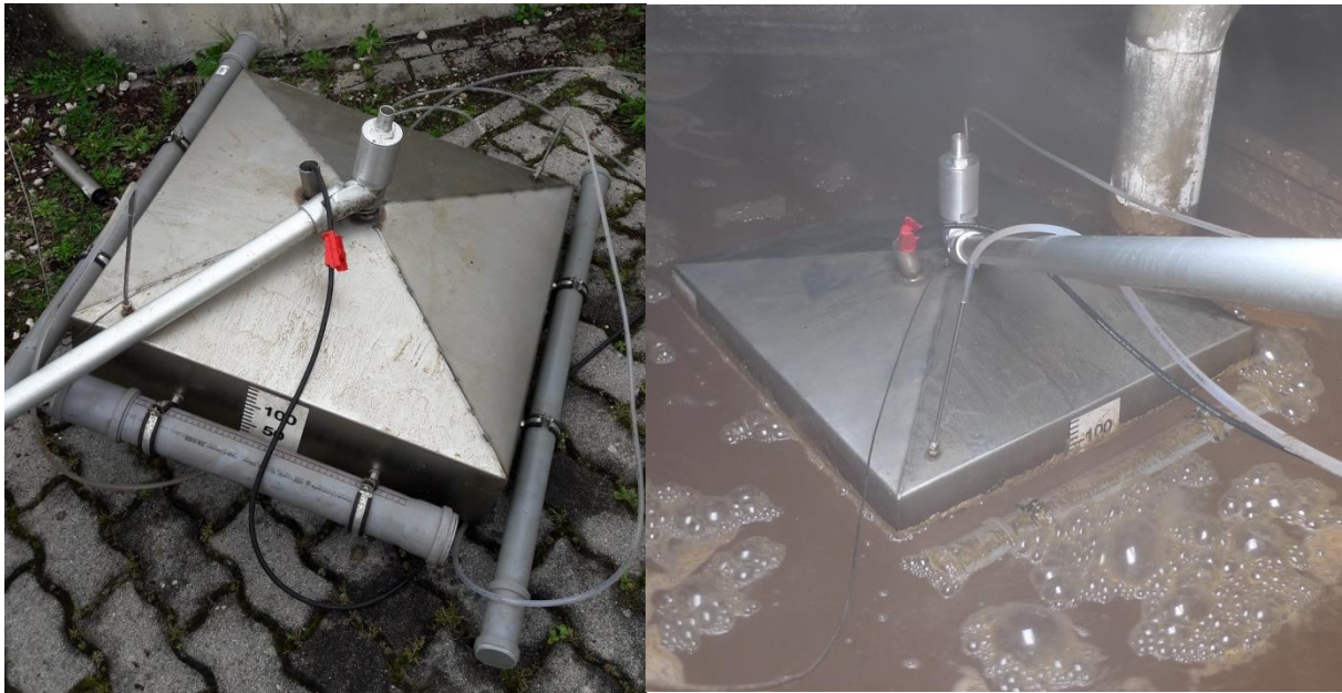
Abbildung 44: Ablufthaube zur Bestimmung der emittierten N_2O -Konzentration in der Kläranlage.
