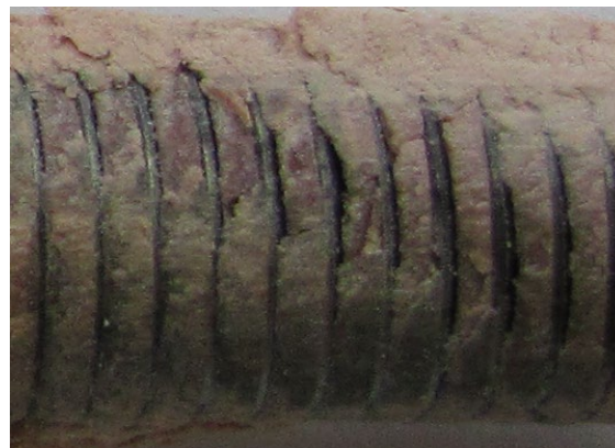
Bild 6-9: Kombiniertes Kohäsionsversagen (Abscheren des Verbundmörtels und Entstehung von Mörtelnasen) und Adhäsionsversagen (Ablösen des Verbundmörtels von den Gewindegängen der Ankerstange) beim Verbundversagen in der Grenzfläche Ankerstange/Verbundmörtel
