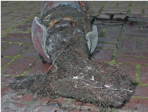
Baumwurzeln haben eine Regenwasserleitung ausgefüllt. (Mit freundlicher Genehmigung von T. Stützel.)
