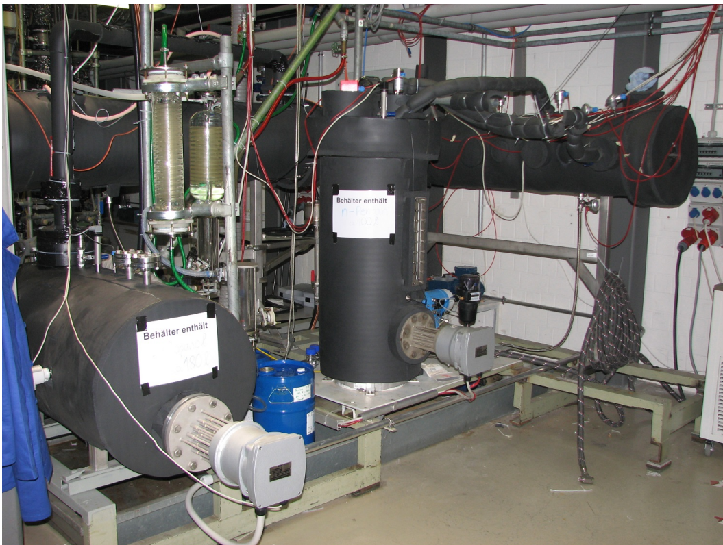
Abbildung 5.3: Foto der Einzelrohr-Anlage
