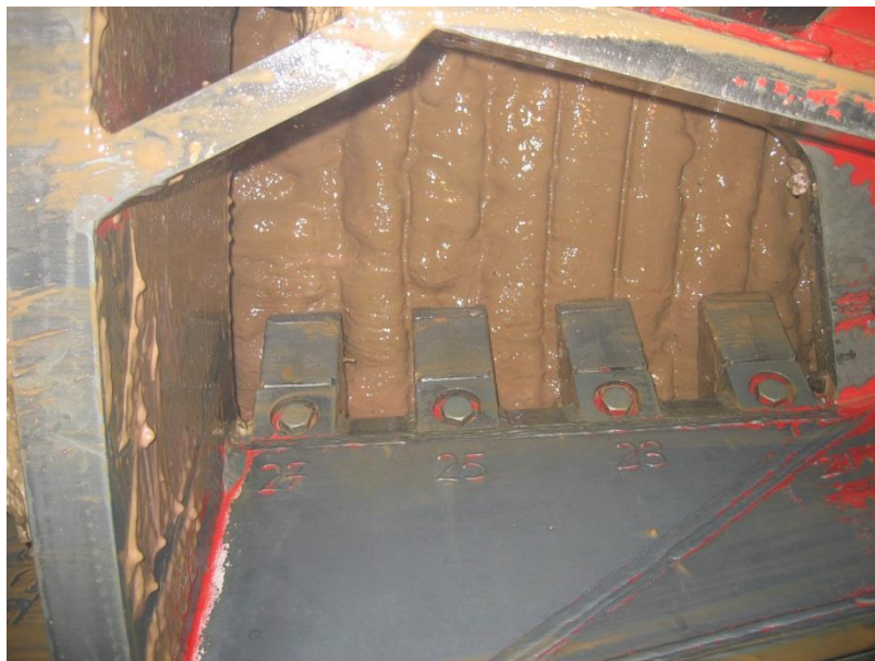
Abb. 2: Blick auf die Ortsbrust durch eine Schneidradöffnung während eines Drucklufteinstiegs. Die Ortsbrust in stark sandigen Kiesen ist mit einem Filterkuchen aus Bentonit überzogen. Im Vordergrund ist die Frontseite und die Verschraubung der Schälmesser auf den Spuren 21, 23, 25 und 27 zu sehen. (Herrenknecht AG)
