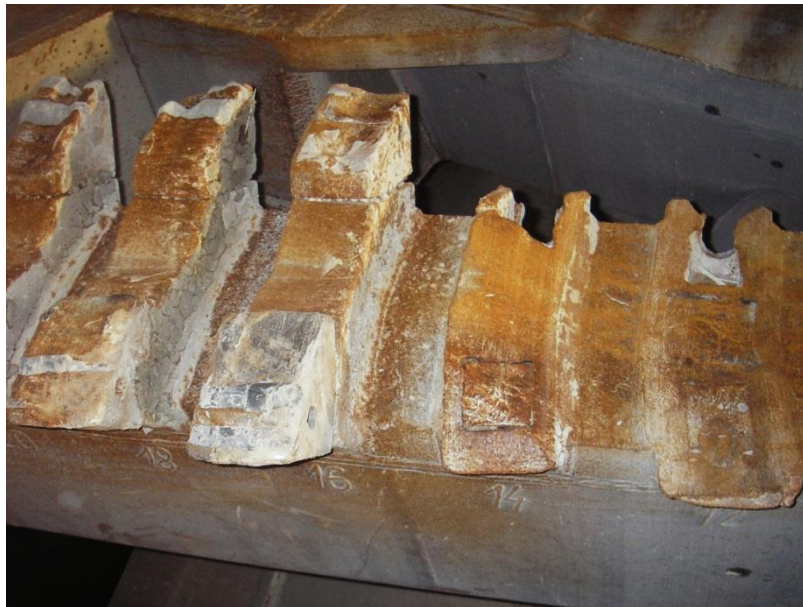
Abb. 56: Frontansicht eines Schneidradarmes nach Vortriebsende. Auf Höhe der Bildmitte sind von links nach rechts fünf Schälmesserpaare bzw. Halterpaare zu sehen. Auf den drei linken Halterpaaren sind noch Schälmesser montiert, die bereits deutlich über die Verschleißgrenze hinaus verschlissen sind (Verschleißschaden). Die Schälmesser der beiden rechten Halterpaare wurden zunächst durch Verschleiß vollständig entfernt, nachfolgend wurden auch die Halter bis auf Höhe der Schneidradstahlstruktur eingeebnet (Verschleißschaden Schneidradstahlstruktur). (Herrenknecht AG)
