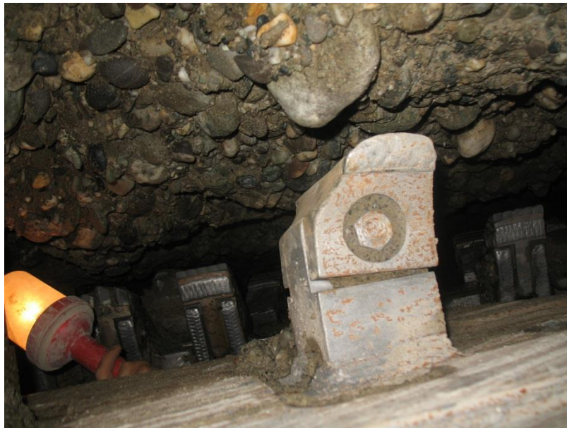
Abb. 48: Blick durch eine Schneiradöffnung auf einen Stichel nach dem Bodenabbau in steinigem Kies. Der Stichelkopf ist durch Verformungen der Befestigungselemente seitlich verkippt. Zusätzlich weist der Stichelkopf einen einseitigen Verschleißschaden auf.
