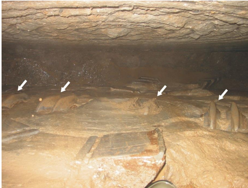
Abb. 43: Blick durch eine Schneidradöffnung auf die Frontseite des Schneidradzentrums. Der sichtbare Bereich ist vollständig mit bindigem Material verklebt. Aus dem anhaftenden Boden stehen die Schneidrollen und Schälmesser hervor. Die Schneidrollen sind durch das anhaftende Material blockiert, die sichtbaren Schneidringe (weiße Markierungen) zeigen deutlich flachgeschliffene Stellen. (Herrenknecht AG, verändert)
