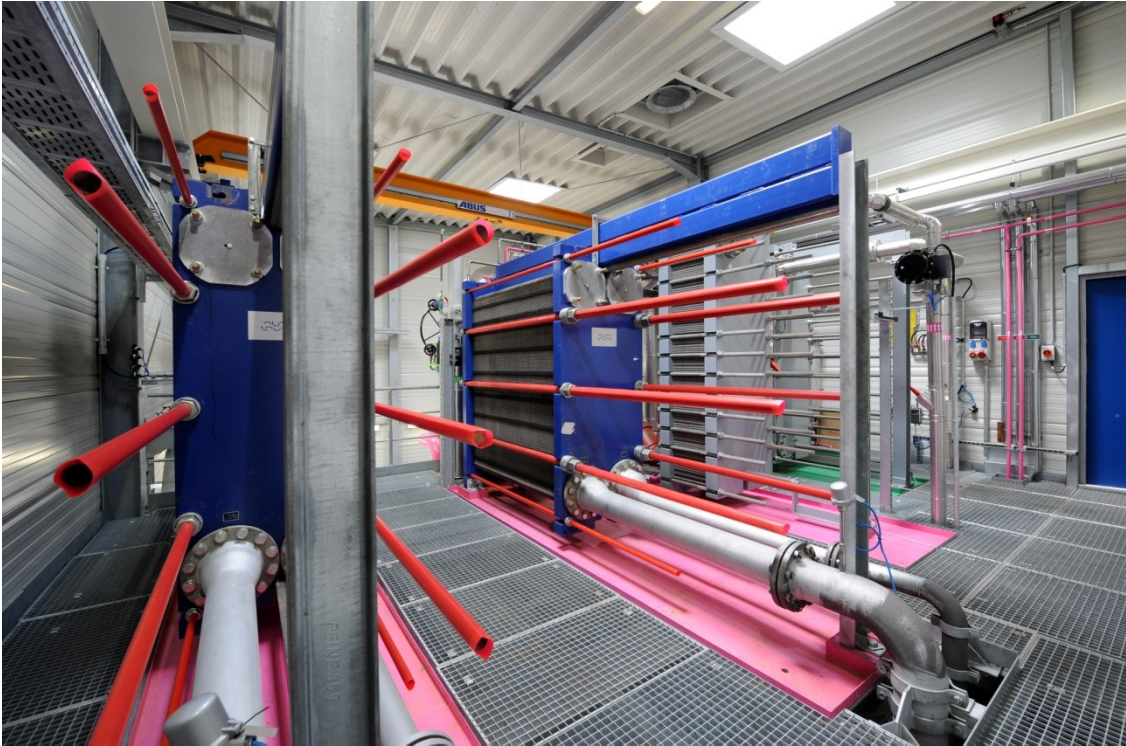
Abb. A-4: Ansicht der Wärmeübertrager des Geothermiekraftwerks Bruchsal vor Montage der Isolierung. Zu sehen sind die beiden Verdampfer (links), der Vorwärmer (Mitte) und der Kondensator (rechts). (EnBW, 2012)
