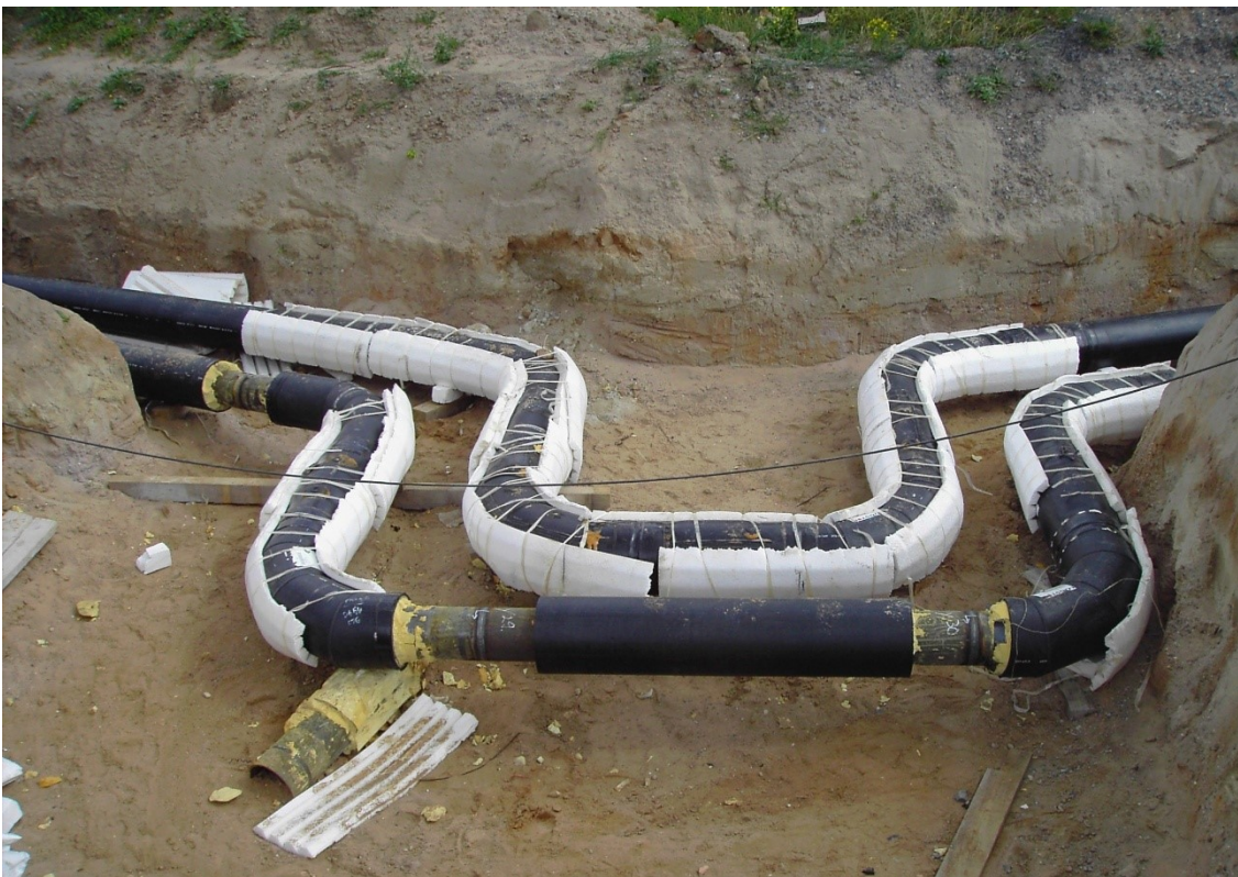
Abb. A-5: Ansicht einer erdverlegten Thermalwasserleitung mit Dehnungsbögen. (EnBW, 2012)
