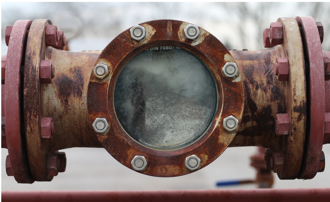
Abb. A-7: Schauglas im Thermalwassersystem des Geothermieprojekts Bruchsal. Zu sehen ist die Zweiphasenströmung aus flüssigem Thermalwasser und entlöstem Gas an der Produktionsbohrung. Die Betriebsbedingungen betragen ca. 120 °C und 22 barü. (EnBW, 2012)
