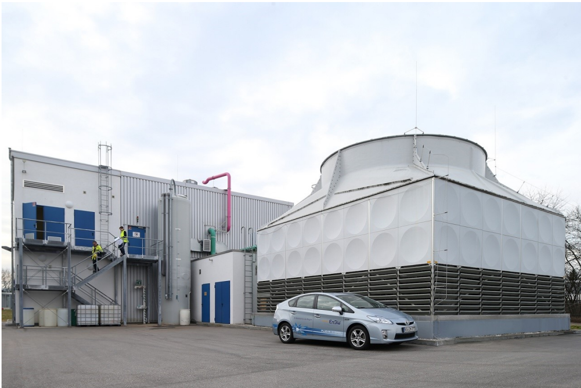
Abb. A-2: Außenansicht des Geothermiekraftwerks Bruchsal. Zu sehen sind das Maschinen- und Pumpenhaus sowie die Nasskühlturmzelle. (EnBW, 2012)
