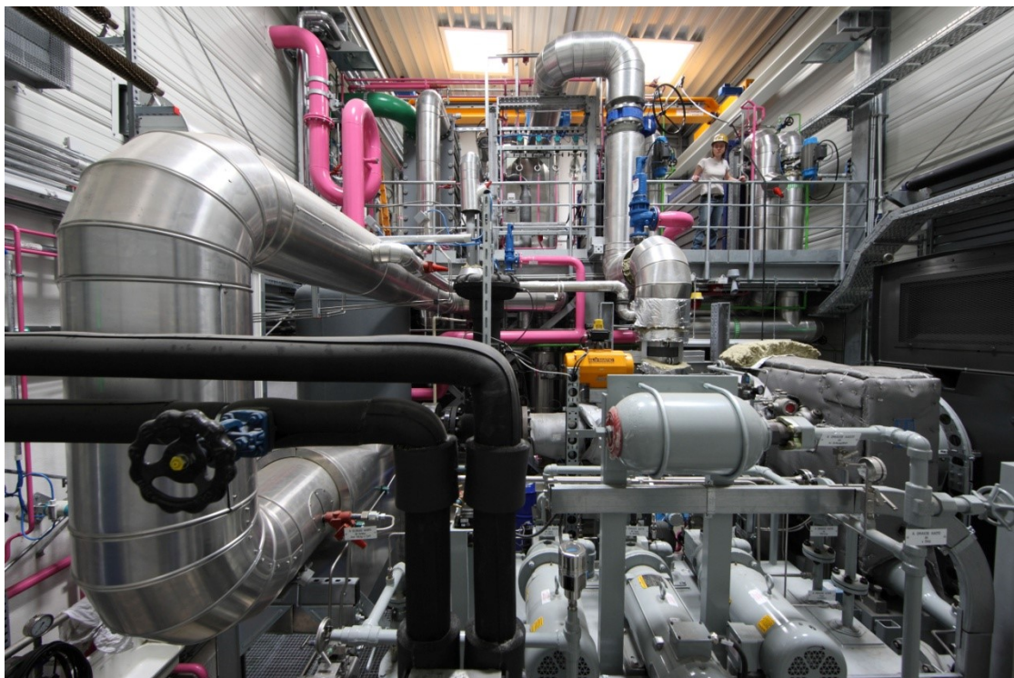
Abb. A-3: Innenansicht des Geothermiekraftwerks Bruchsal. Zu sehen ist der Turbosatz (vorne im Bild) und die Plattenwärmeübertrager auf der oberen Ebene (hinten im Bild). (EnBW, 2012)
