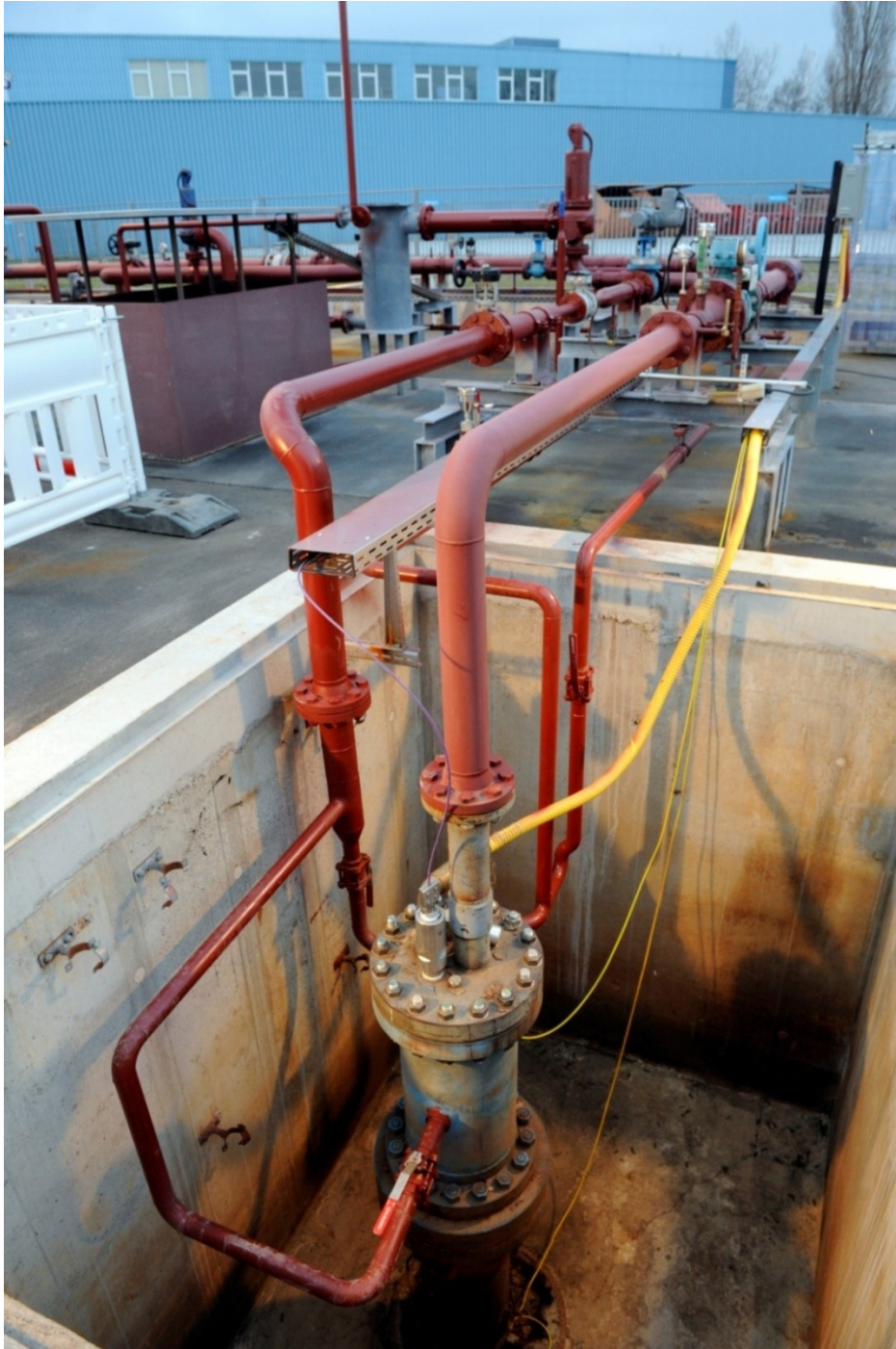
Abb. A-1: Brunnenkopf der Produktionsbohrung (GB2) des Geothermiekraftwerks Bruchsal. Zu erkennen sind die Thermalwasserleitungen (rote Rohrleitungen), das Stromkabel zur Stromversorgung der Förderpumpe (gelbes Kabel) sowie eine weitere Durchführung durch den Brunnenkopf für eine Druck- und Temperatursonde (lila Kabel). (EnBW, 2012)
