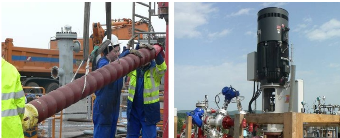
Abb. A-9: Pumpenkörper (links) und Motor (rechts) einer LSP im Geothermieprojekt Soultz-sous-Forêts. (EEIG Heat-Mining, 2012)
