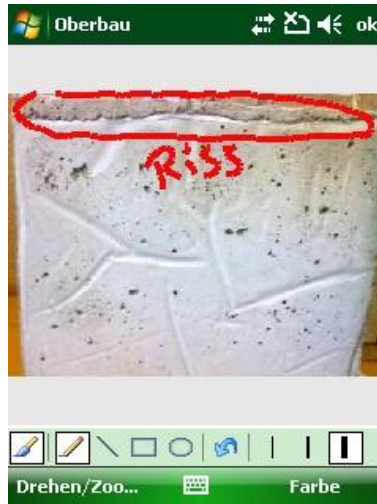
Abbildung 3.4-3 Kennzeichnung eines Rissverlaufs
