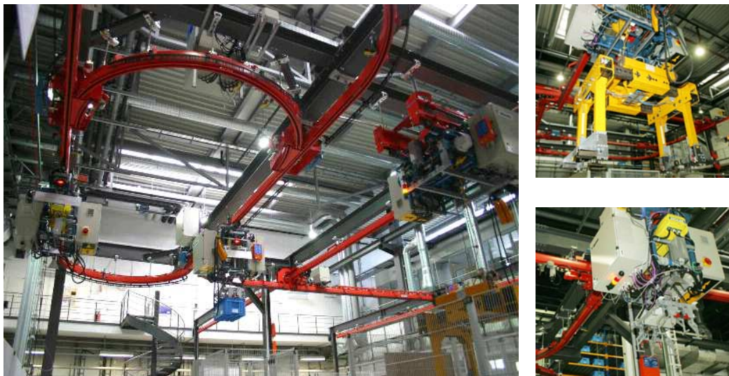
Abb. 8-1: Elektrohängebahnanlage (EHB)(links) und Laufkatzen (rechts)
