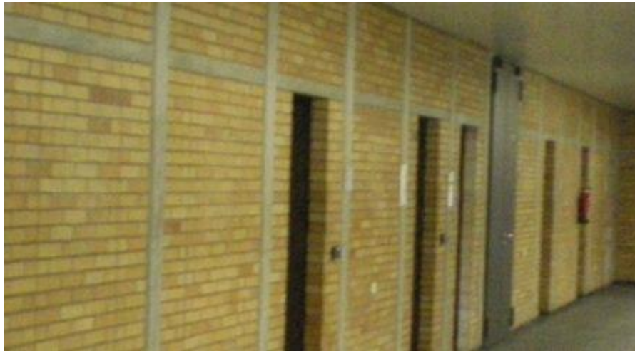
Abbildung 4-2 Wände im Nordgebäude - zwischen Büros und dem Flur bestehen die Wände aus einem von Betonsäulen gestützten Mauerwerk.
