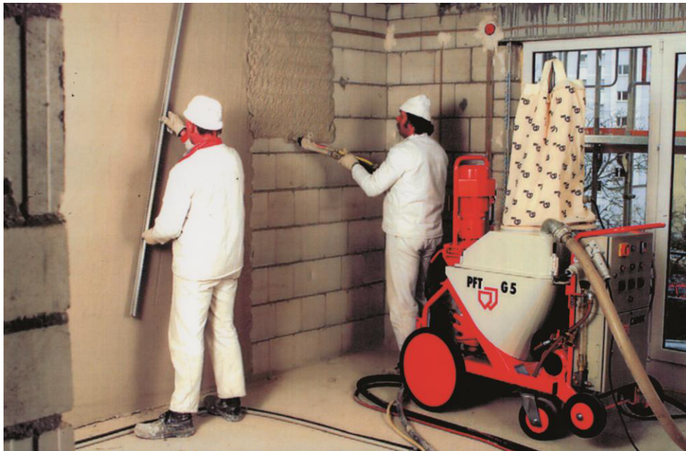
Abbildung 9 – Auftragen eines Gips-basierten Maschinenputzes an die Wand mittels Knauf PFT G5 Verputzmaschine und anschließendes Glattziehen [59].
