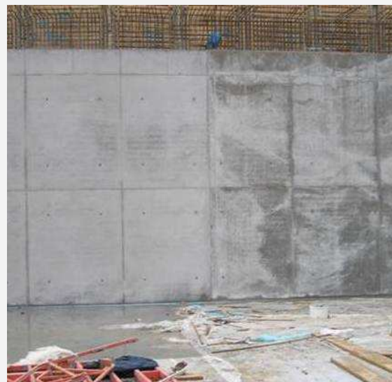
Abbildung 121: Einfluss der Frischbetontemperatur auf das optische Erscheinungsbild der Sichtbetonoberflächen bei einer Winterbetonage (Lufttemperatur: -3\text{ }^{\circ}\text{C} ), Frischbetontemperatur rechter Wandteil: rd. 10\text{ }^{\circ}\text{C} , linker Wandteil: rd. 25\text{ }^{\circ}\text{C} (Foto: H. FIALA)
