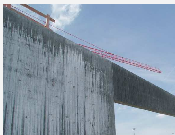
Abbildung 1: Ausgeprägte Weißverfärbung an einem schwarz pigmentierten Beton (Foto: Ingenieurbüro Schiessl Gehlen Sodeikat GmbH)
