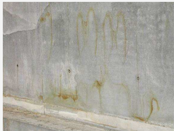
Abbildung 2: Braunverfärbungen infolge eines instabilen Phenolharzfilms der Schalung (Foto: H. FIALA)
