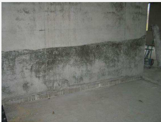
Abbildung 4: Dunkelverfärbung im unteren Bereich einer Wand (Foto: H. FIALA)
