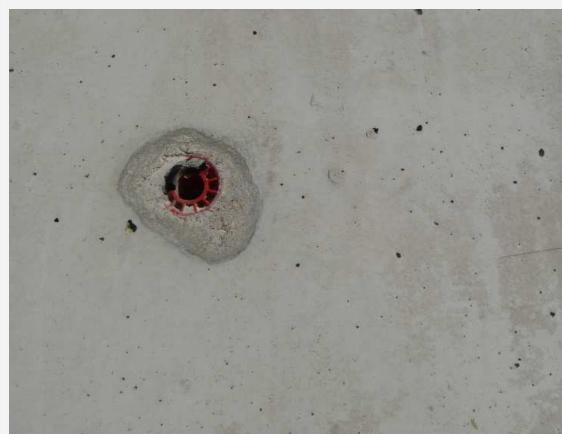
Abbildung 3: Dunkelverfärbungen an einem undichten Schalungsanker
