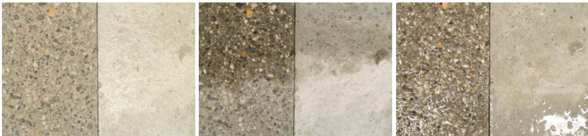
Abbildung 7.22: Feuchtezustand von Oberflächen (jeweils druckwassergestrahlt und rüttelrau)
