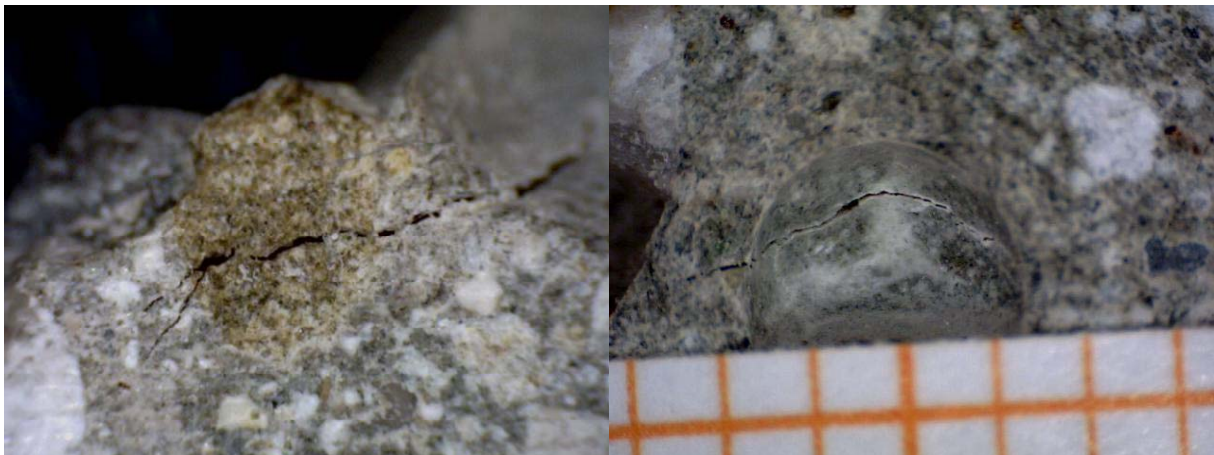
Abbildung 8.14: gestemmtete Oberfläche, breite durch Zuschläge verlaufende Risse
