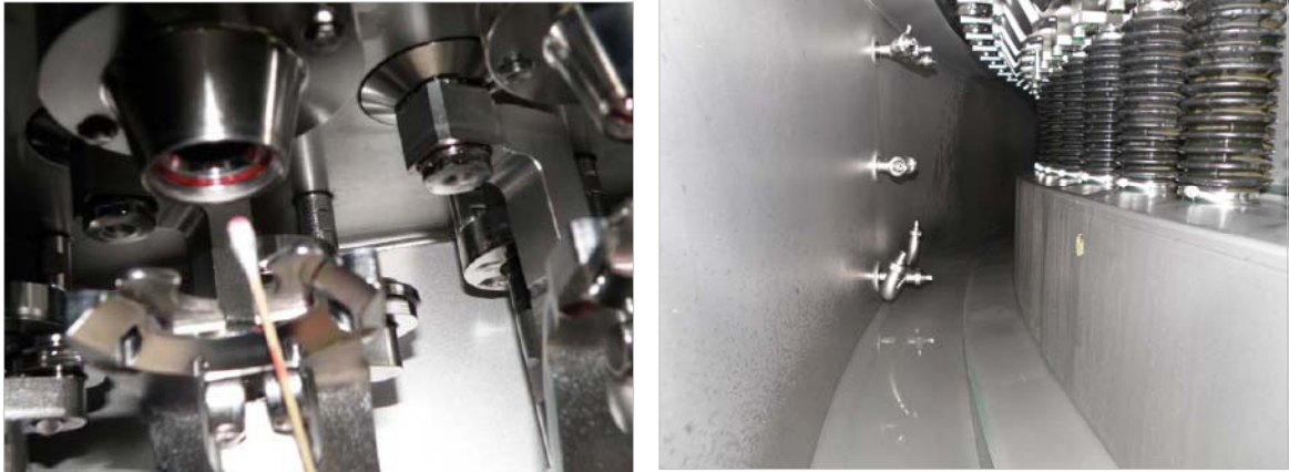
Abbildung 73: Spritzschatten im Bereich der Füllventile / Lösung Zielstrahlreiner
