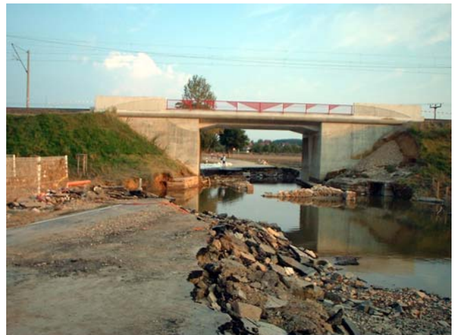
Abbildung 4: Schäden durch das Hochwasser der Mulde im Jahr 2002 (Quelle: Flutbilder der Gemeinde Bennewitz)
